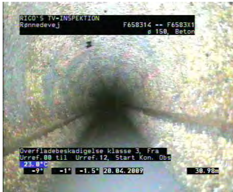
Eksempel på korroderet ledning
