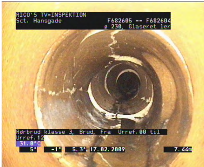
Eksempel på revner i lerledning
